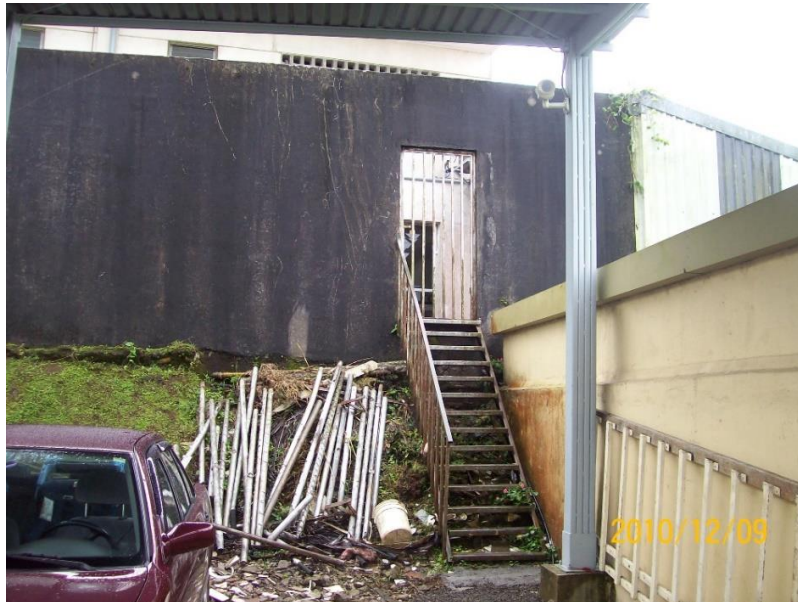
Centro Regional de San Carlos. El antes. Escaleras de acceso al parqueo institucional del Centro Regional de San Carlos. Por su condición no era posible usarlo.
